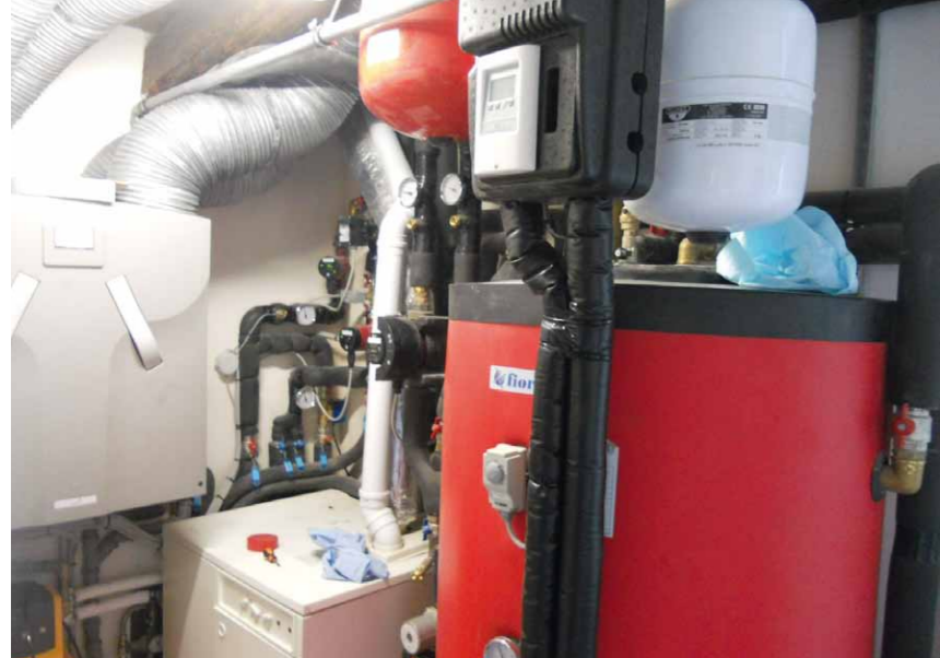
Il vano tecnico con il nuovo impianto di ventilazione meccanica controllata
